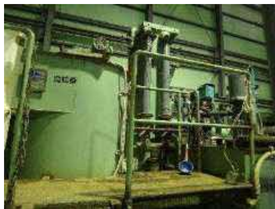
(b) 濁水処理設備
