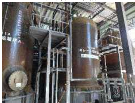
(d) 脱ホウ素設備(2号機)
