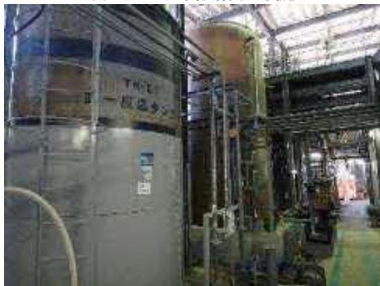
(e) 脱窒素設備
